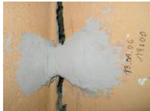
Abb. 18: Gippsiegel über einem Riss
