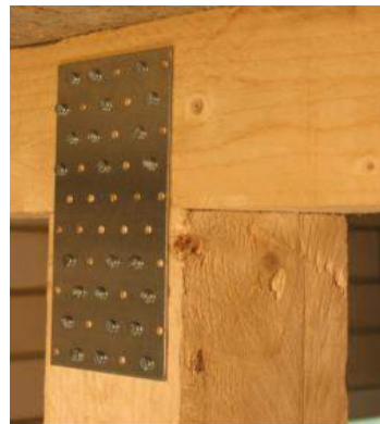
Abb. 31: Platten für Fixierungen (Blockhaus, THW)
