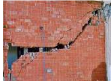
Abb. 3: Gerissene Wand aus Backstein
