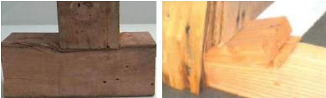
Abb. 16: In die Schwelle- oder den Unterzug eingedrückte Stützen zeigen eine Überlastung des Abstützsystems an (FEMA)
