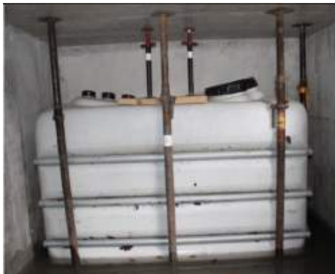
Abb. 82: Sicherung eines Heizöltanks (Gebäudeversicherung Bern GVB).
