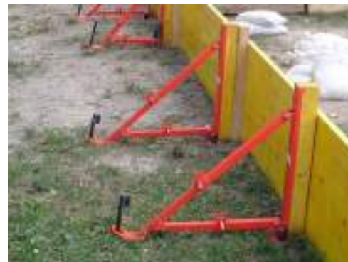
Sicherung mit verstellbaren Abschalböcken aus dem Bausektor
