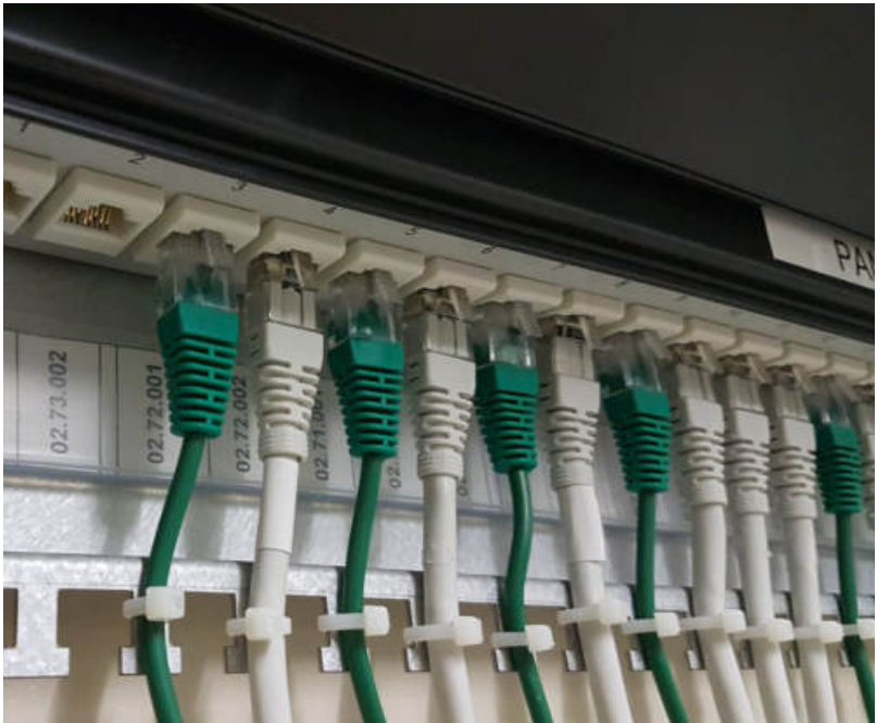
Abb 46: Verteiler mit den nummerierten Anschlüssen.
