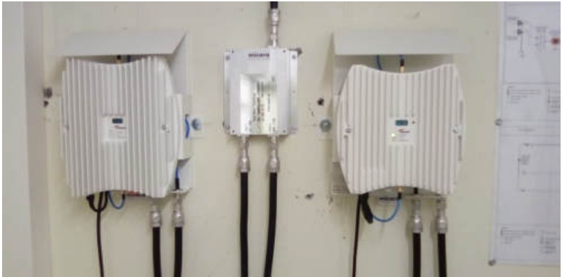
Abb. 35: Beispiel eines Polycom-Repeaters (links), einer Frequenzweiche (Mitte) und eines Mobilfunk-Repeaters (rechts).
