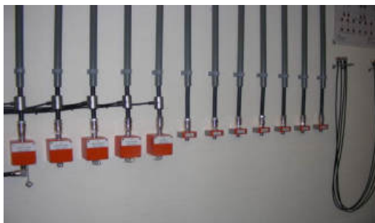
Abb. 34: Funkinstallationen im Telematikzentrum mit Verbindungskabel (rechts).
