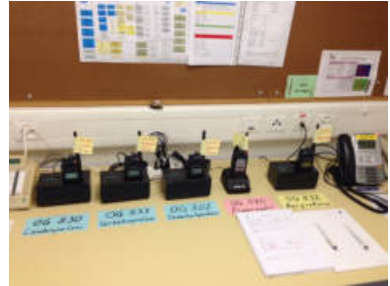
Abb. 7: Beispiel eines Telematik-Arbeitsplatzes am Führungsstandort.
